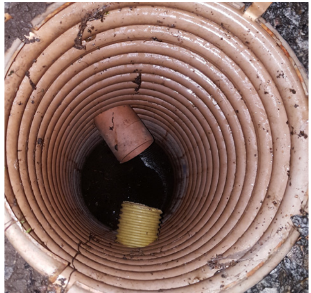
Tillsynsbrunn med sandfång i botten.
