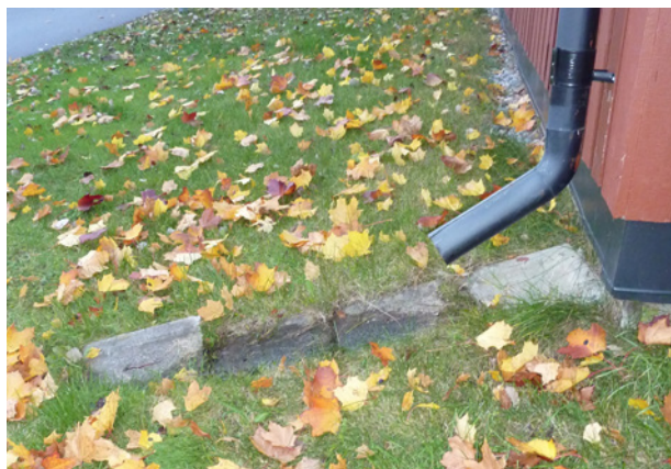
Takdagvatten leds ut på gräsytor via rännalsplattor. Rännalsplattor skyddar husgrunden mot fukt.
